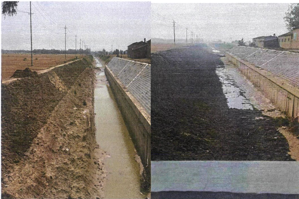
左图为桥梁东边整改前情况，右图为桥梁东边整改后的情况
